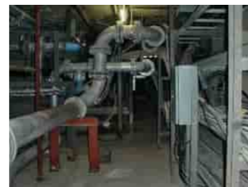
共同構配管・配線
