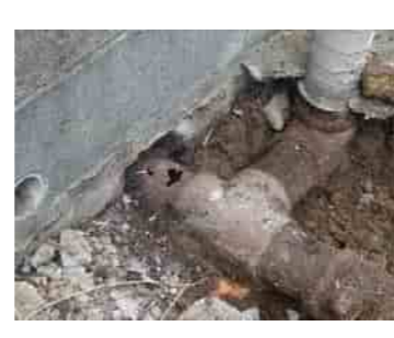
埋設管の腐食
