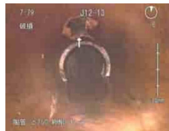
屋外排水管破損
