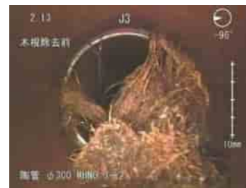
屋外排水管木の根の詰まり
