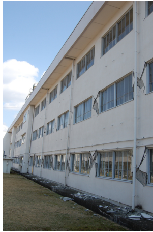
(b) 北側には腰壁や垂れ壁があり、柱が短い
