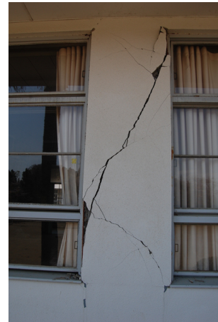
(f) せん断柱全体に及ぶひび割れ
