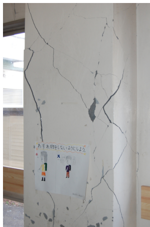
(h) 仕上げモルタルのずれ、ひび割れ分散
