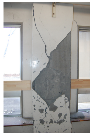
(i) 仕上げモルタル剥落、コンクリートの損傷は小さい
