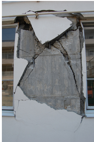
(e) 極短柱ではせん断ひび割れがスパン中央に及ぶ
