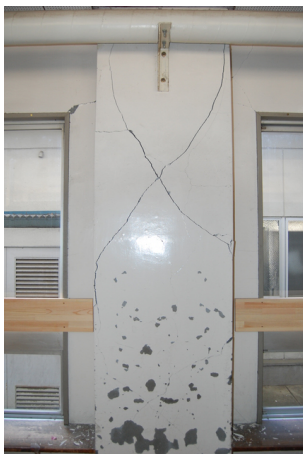
(g) スパンが長い場合、損傷箇所が上下に偏る場合がある
