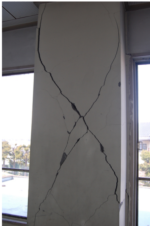
(d) 北側構面の全ての柱にせん断ひび割れが発生
