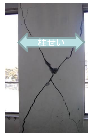
極短柱のせん断破壊
