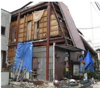
タイル張り外壁材の全面脱落
