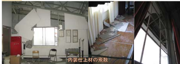
内装仕上材の飛散
