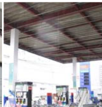
↑ ガソリンスタンド 天井の全面落下→
