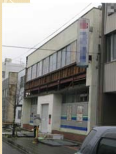
店舗看板の脱落
