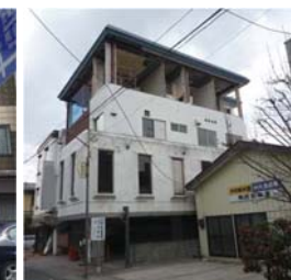
ALC板外壁の全面脱落
