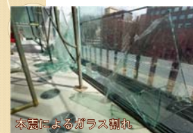
本震によるガラス割れ
