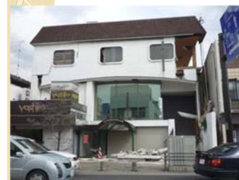
外壁材の脱落
