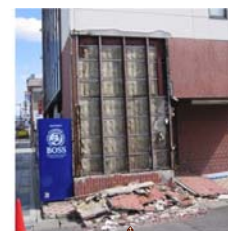
↑ タイル壁の脱落
