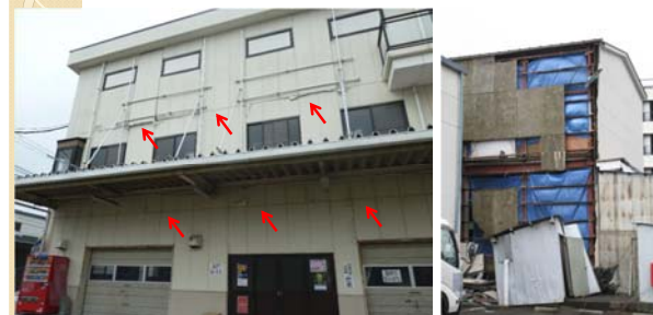
ALC板ジョイント部での損傷
