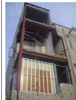
ALC板外壁の全面脱落
