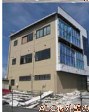
ALC板外壁の全面脱落
