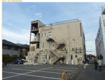
ALC板外壁の落下
