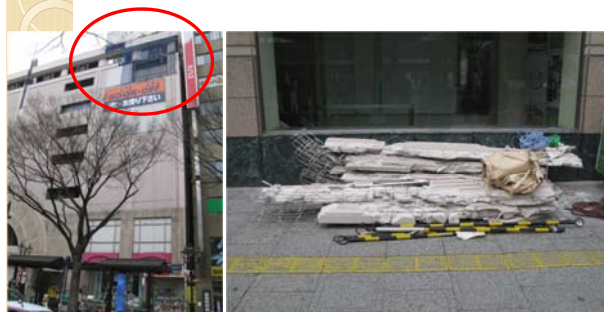
外装材落下によるけが人はない
