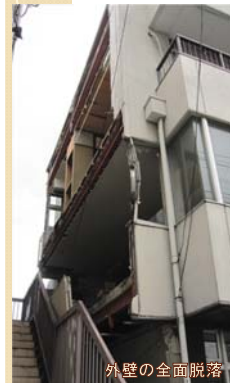
外壁の全面脱落
