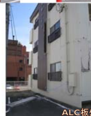
ALC板外壁の部分的損傷
