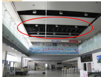
天井仕上材の落下
